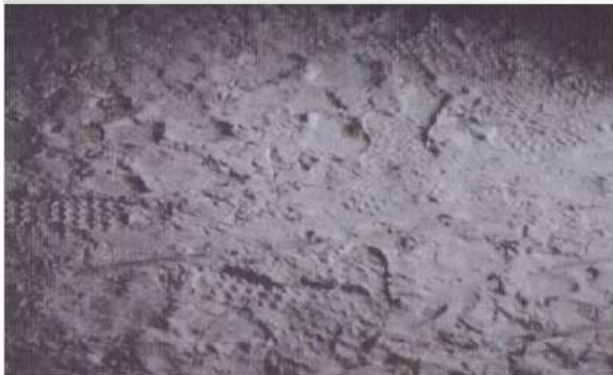
Strati di polvere alimentare in pavimento silos grano (P, S)
