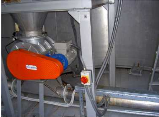
Zona estrazione e trasporto Pneumatico, tramoggia silos (No SE)
